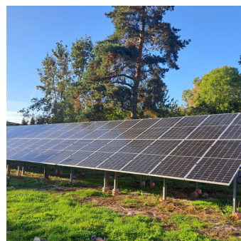
Antonín P. (pozemní FVE) 20 kWp, Nové Sedlo realizace 07/2023
