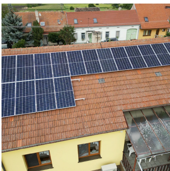
Miroslav P. 7,2 kWp + baterie 10,65 kWh
